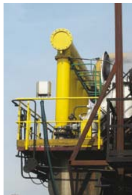
Fot. 2. Instalacja demonstracyjna regulacji ciśnienia w komorze koksowniczej
